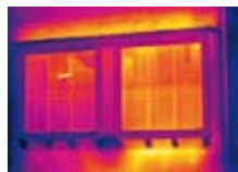
Bâtiment : déperdition énergétique
