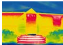
Bâtiment : déperdition énergétique
